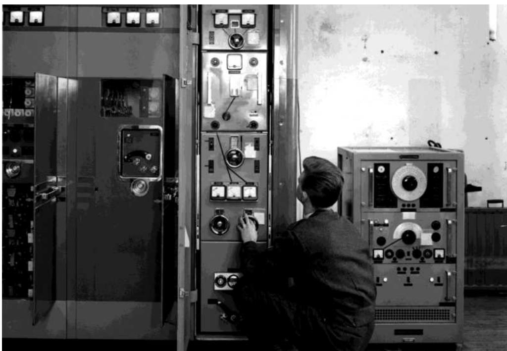
Math J.L. Nielsen i gang med at tune DS-10 senderen i bygning 722.
