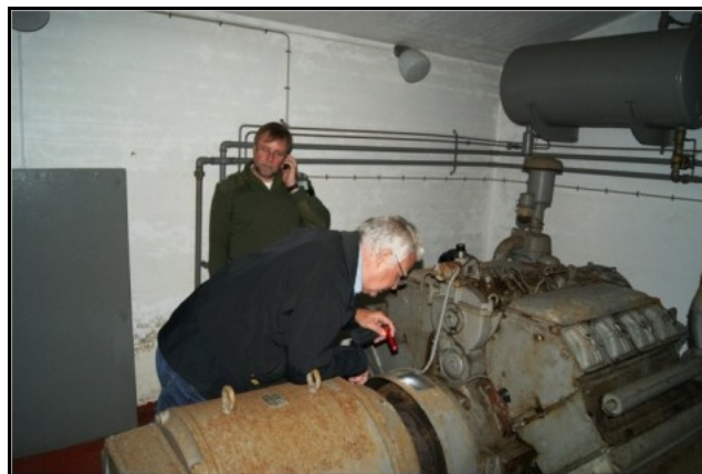
Nødstrømsgeneratoren står stadig i sin bunker.
